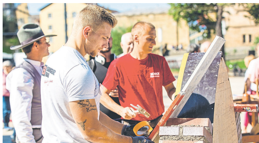
In Freiburg zeigten die Maurer unter den Augen der staunenden Besucher ihr Können beim Rundbogenbau.
