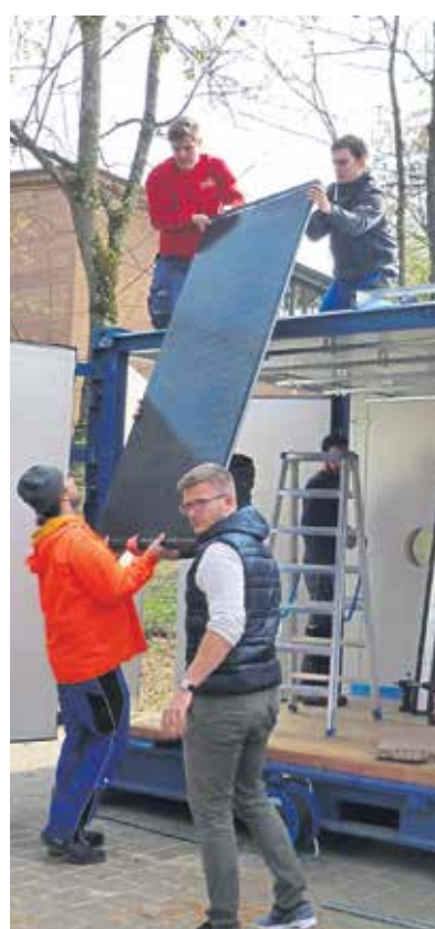
Die Photovoltaik-Paneele versorgen den Container mit Energie.
