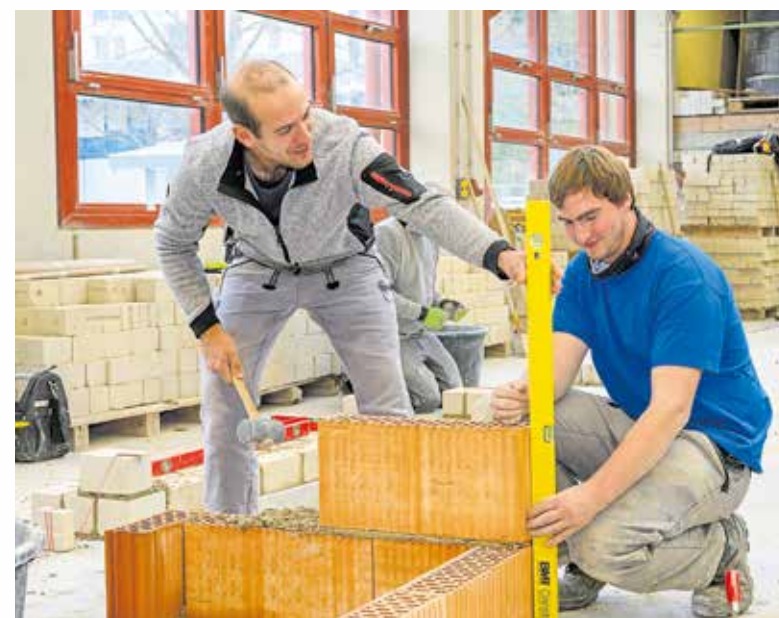
Die überbetriebliche Ausbildung in den Bauberufen ist seit dem 1. September 2022 neu organisiert. Foto: HWK FR
